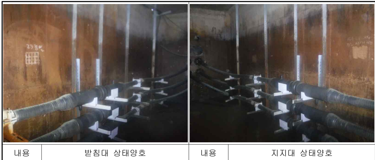
【사진 12.24】 부속 및 부대설비 현황
