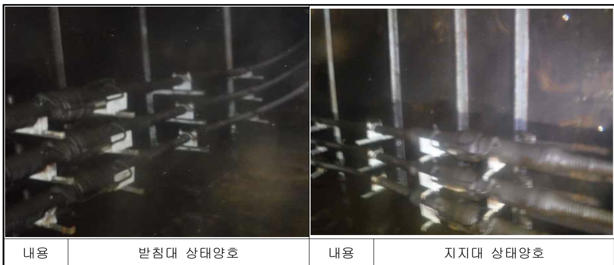
【사진 12.28】 부속 및 부대설비 현황
