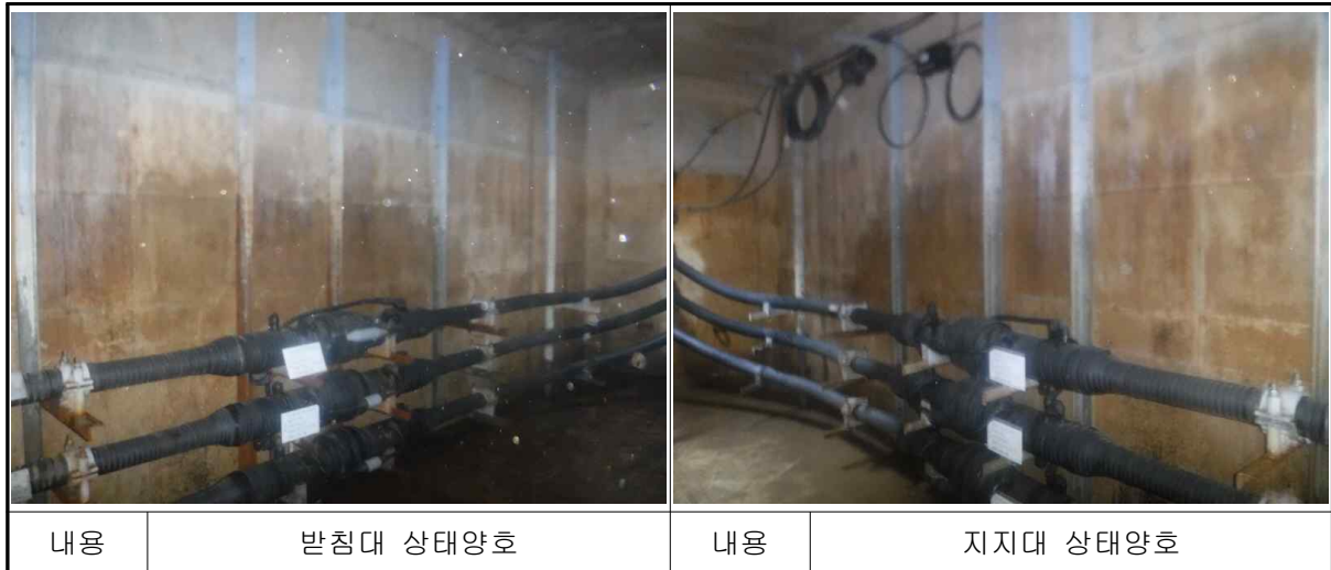
【사진 12.20】 부속 및 부대설비 현황
