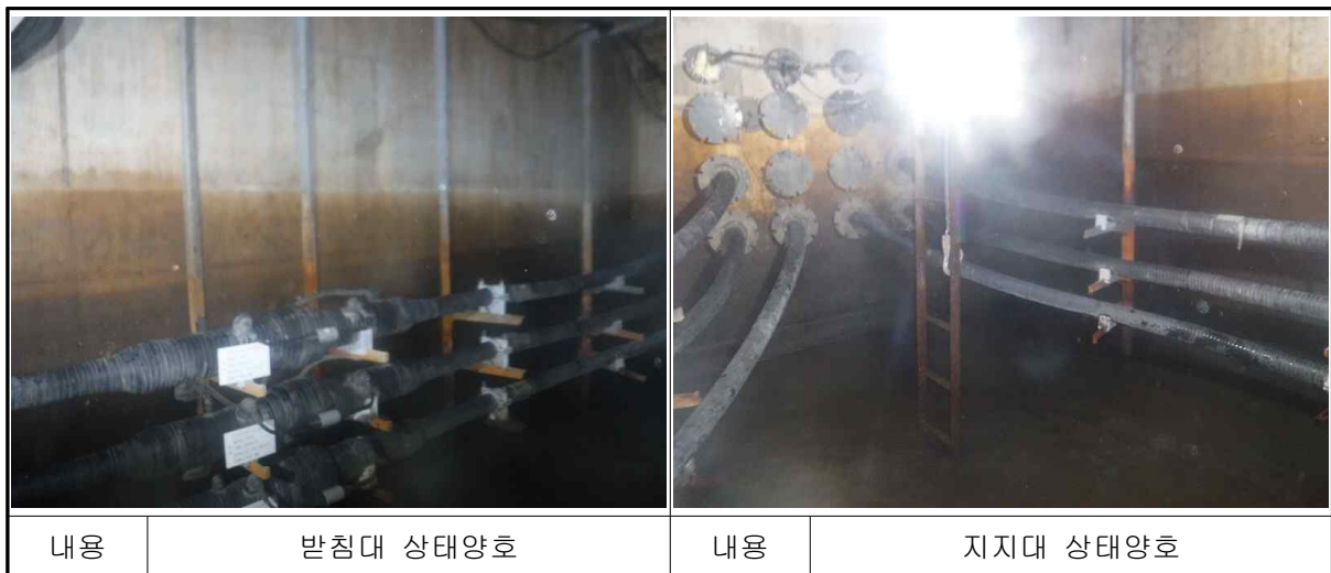
【사진 12.40】 부속 및 부대설비 현황
