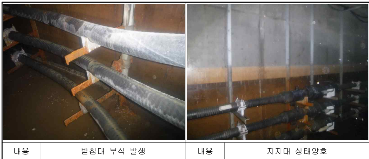
【사진 12.32】 부속 및 부대설비 현황
