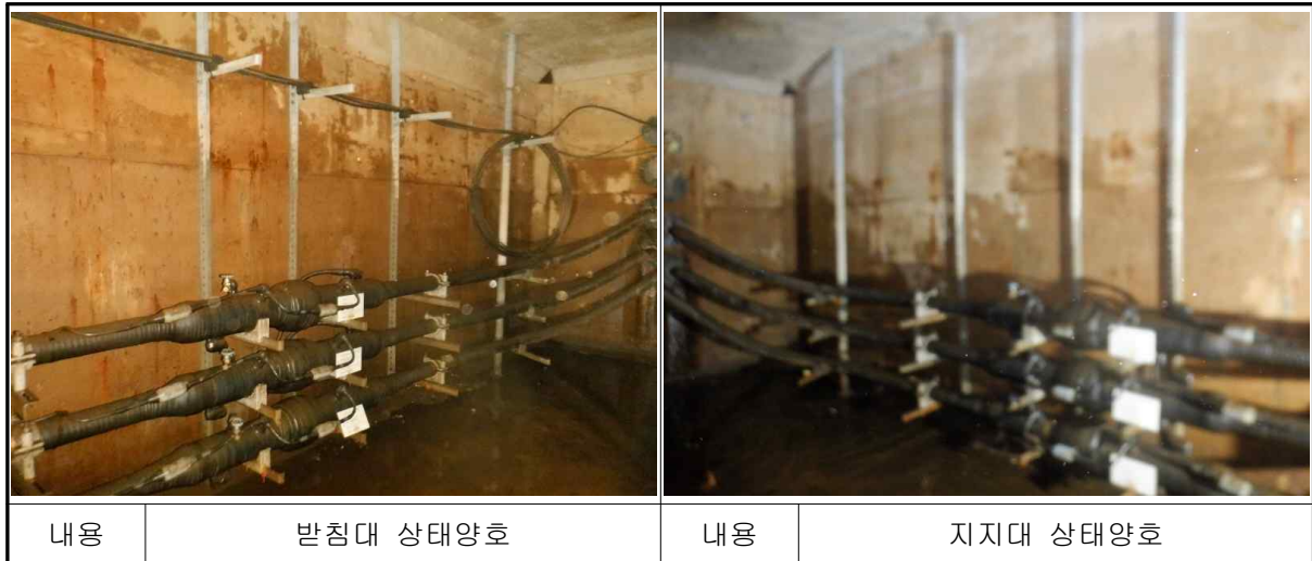
【사진 12.56】 부속 및 부대설비 현황
