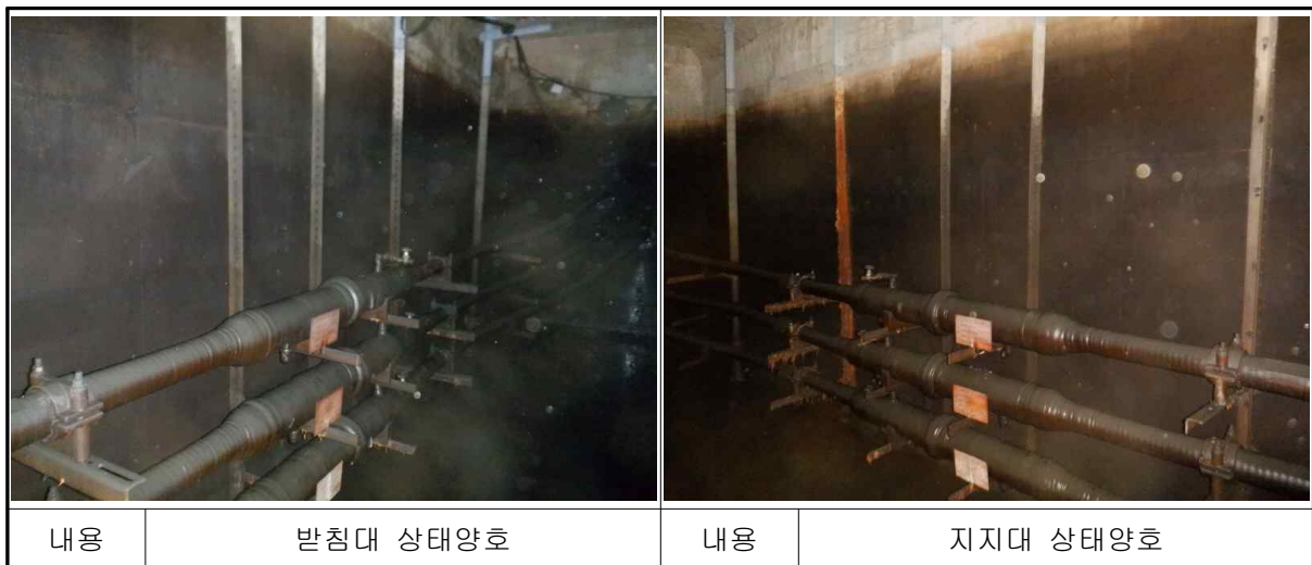
【사진 12.48】 부속 및 부대설비 현황
