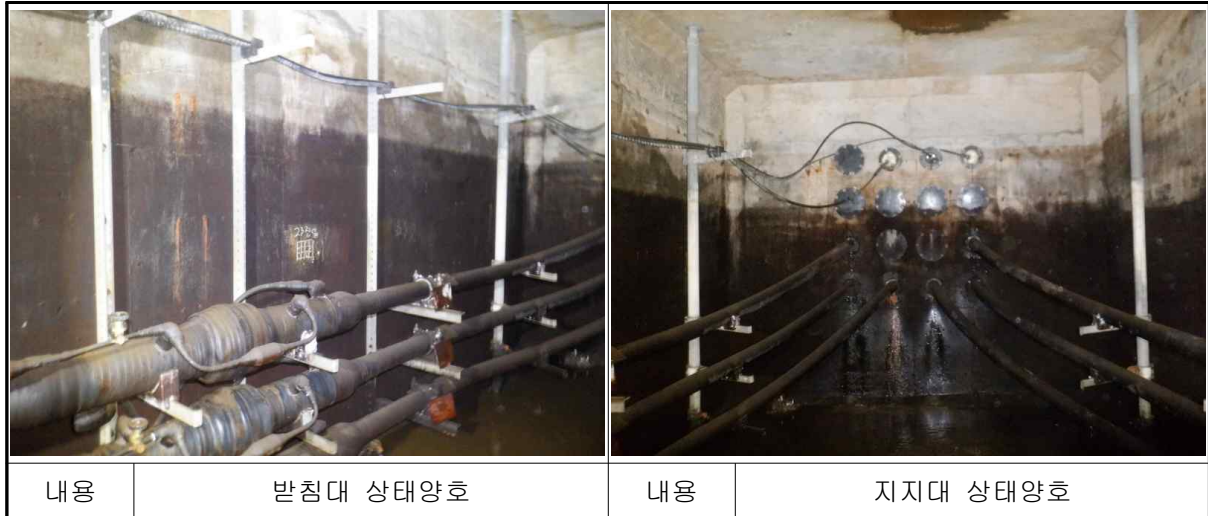
【사진 12.52】 부속 및 부대설비 현황
