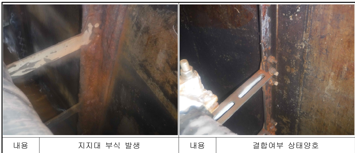
【사진 12.12】 부속 및 부대설비 현황
