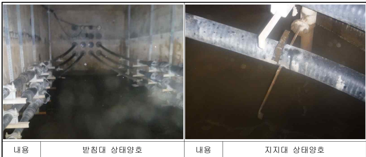
【사진 12.44】 부속 및 부대설비 현황
